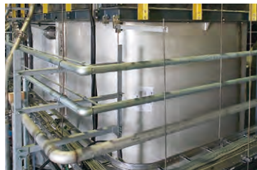
脱硫・中和槽
