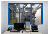
コントロールルーム
