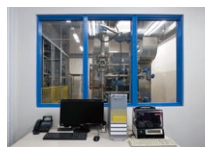
コントロールルーム
