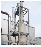
排ガス洗浄装置（スクラバー）
