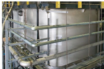
脱硫・中和槽
