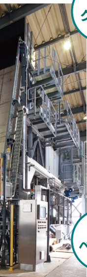
破碎機 ーダーを含めた破碎棟）
