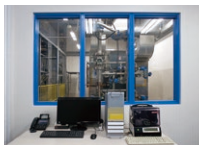
コントロールルーム
